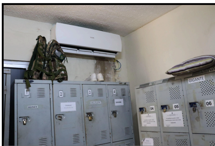
Ocorrência de infiltração junto ao ar-condicionado do quarto de descanso dos(as) trabalhadores(as). Fonte: MEPET/ES, 2025.
