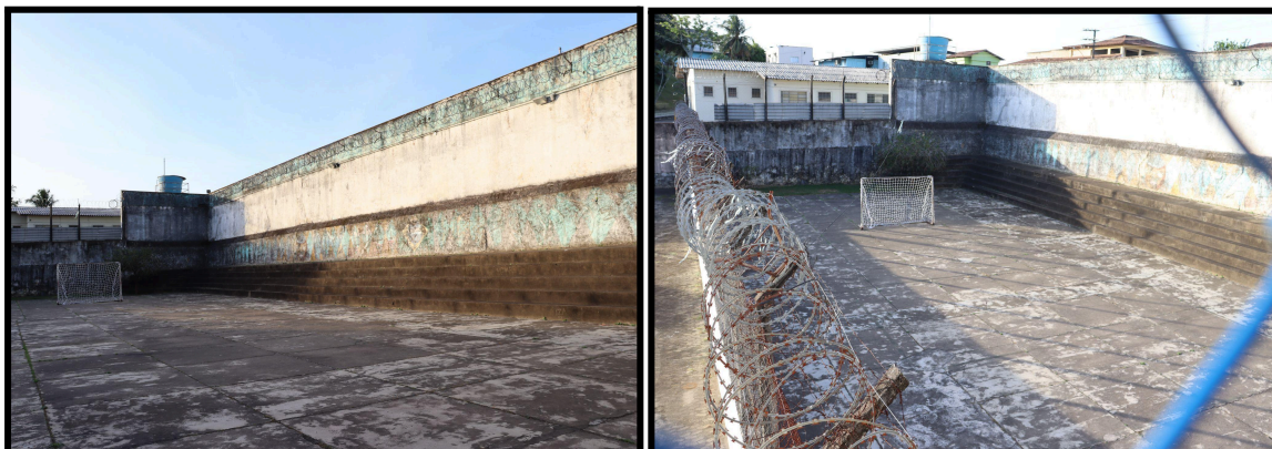
Quadra externa: (a) vista do espaço descoberto, com piso de concreto, arquibancada e estrutura do gol, além de paredes e piso com pintura deteriorada pelas intempéries; (b) vista superior revelando concertinas corroídas, que reforçam estética e função de contenção típicas do sistema prisional. Fonte: MEPET/ES, 2025.
