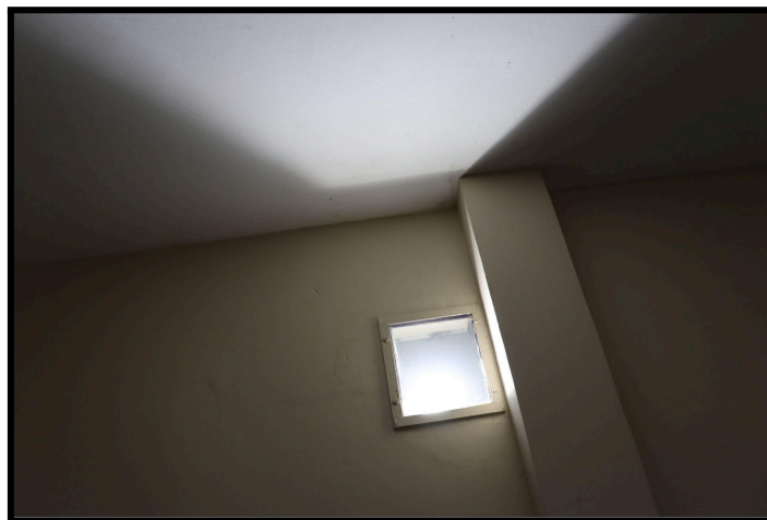
Iluminação dos alojamentos. Fonte: MEPET, 2025.
