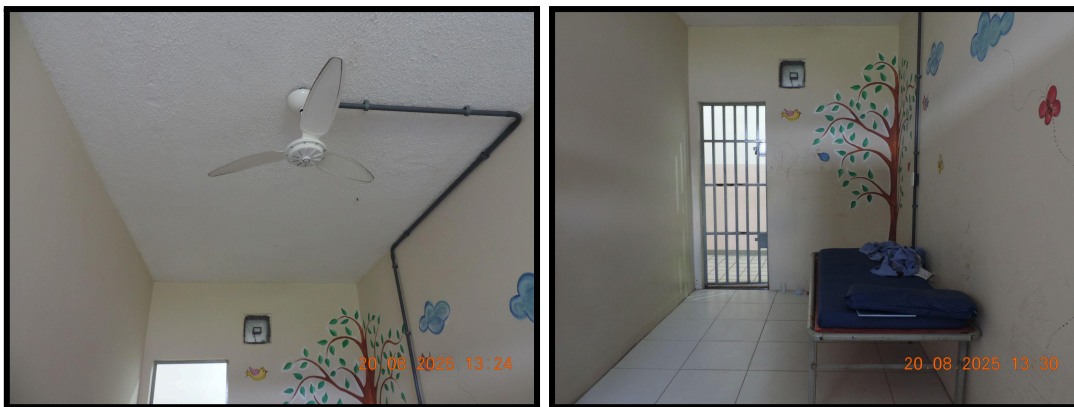
Estrutura interna do alojamento materno-infantil: (a) teto com ventilador e luminária fixada na parede de entrada; (b) vista da cama metálica tipo maca e da porta de entrada. Fonte: MEPET/ES, 2025.
